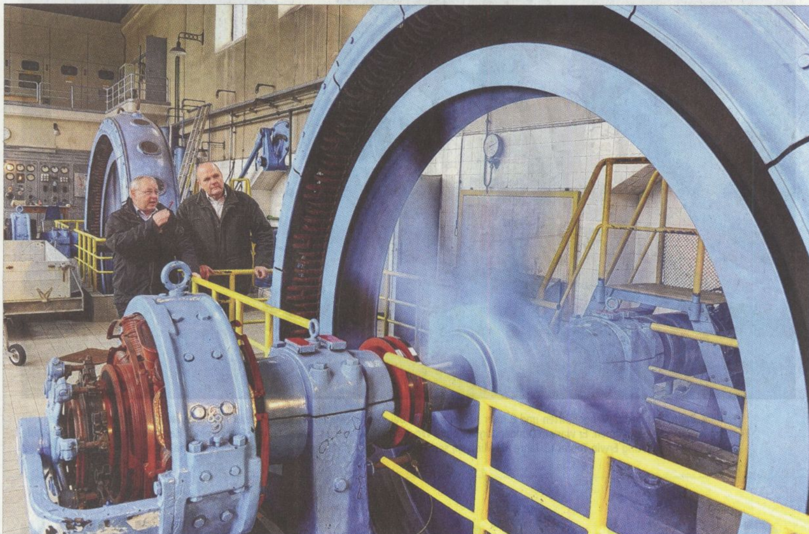
Seit 1928 erzeugen im Kraftwerk Reutlingen-Altenburg zwei Generatoren Strom aus der Kraft des Neckars. Betreiber Elmar Reitter (links) hat das Werk ökologisch und technisch optimiert. Neben ihm der Präsident der AG Wasserkraftwerke Baden-Württemberg, Karl-Wilhelm Röhm. Foto: Klaus Franke
